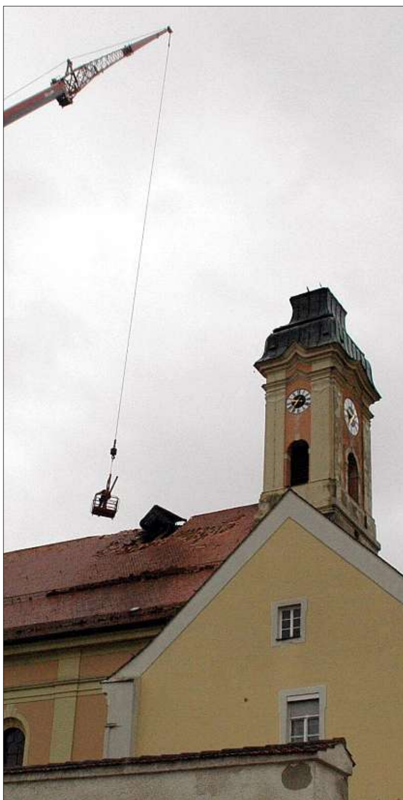
Mittels Kran wurde gestern immer wieder versucht, Material zur Abdeckung aufs Dach zu hieven oder die abgebrochene Spitze herunterzuheben. Doch der heftige Sturm ließ beides nicht zu. – Fotos: tf/as/gs
