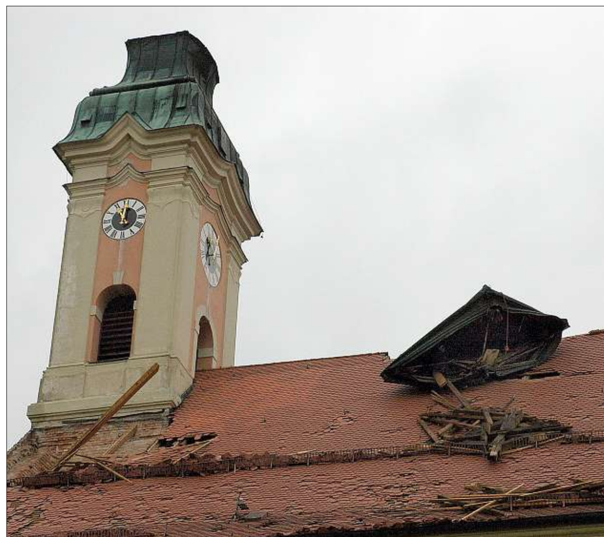
Erschreckend auch der Anblick vom Klosterinnenhof aus: Wie ein großes Fischmaul gähnt die abgebrochene Turmspitze vom Dach. Unterhalb des Turms klafft ein großes Loch, das Einblick gibt bis ins Gemäuer.
